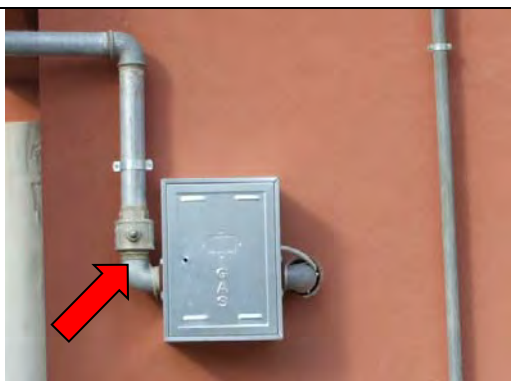
Dispositivi d'intercettazione del gas installato in prossimità del locale caldaia.
