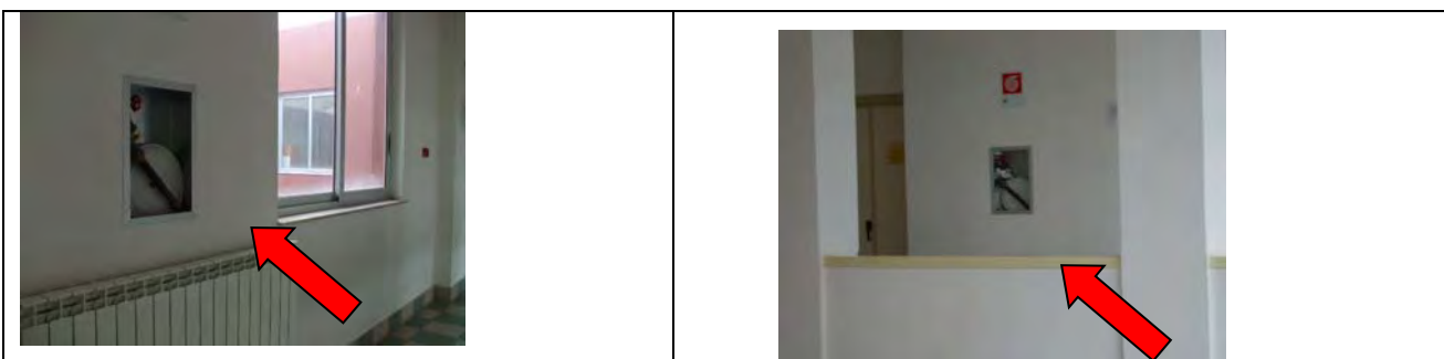
Idranti posti lungo i corridoi del primo piano.
