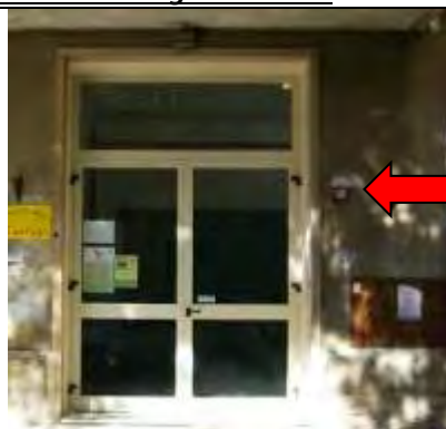
Dispositivi d'intercettazione dell'energia elettrica installato in prossimità dell'uscita di sicurezza che immette in Via V. Veneto angolo Via Toscanini
