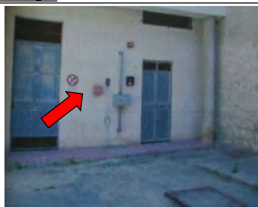
Dispositivi d'intercettazione del gas installato in prossimità del locale caldaia.
