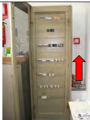
Dispositivi d'intercettazione dell'energia elettrica installato accanto al quadro di distribuzione installato nella bidelleria dell'ala nuova.
