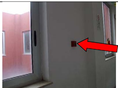
Comando posto al primo piano posto lungo il corridoio principale
