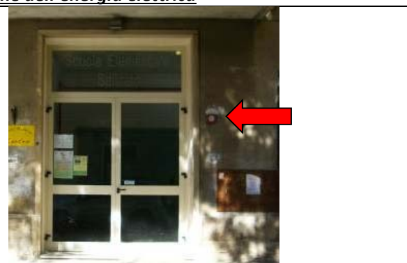
Dispositivi d'intercettazione dell'energia elettrica installato in prossimità dell'uscita di sicurezza che immette in Via V. Veneto angolo Via Toscanini
